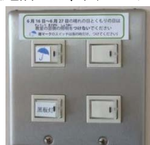
窓側回路のスイッチに「雨マーク」
